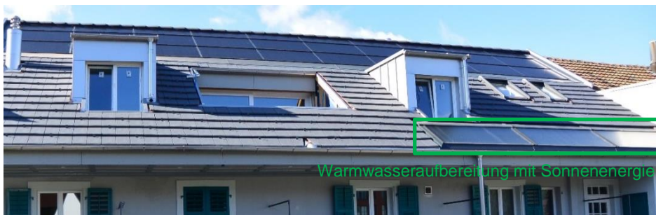
Abbildung 2: Steildach mit Solarzellen für Strom und Warmwasseraufbereitung
