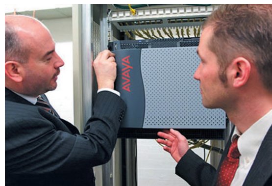
Le coeur de la solution. Grâce à la technologie de téléphonie sur IP, les installations techniques Avaya S8500/G650 sont réduites au minimum
